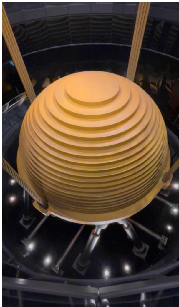
Figura 3: Il sistema SMA installato nel grattacielo Taipei 101.
