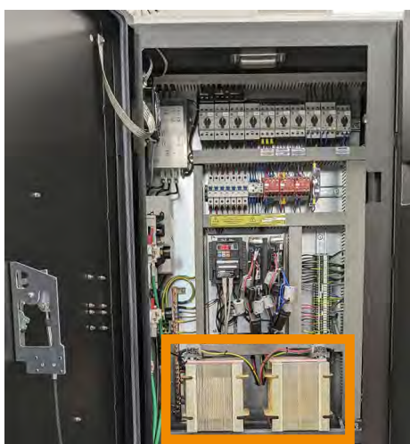
Imagen 70 Dos transformadores en el armario eléctrico trasero izquierdo
