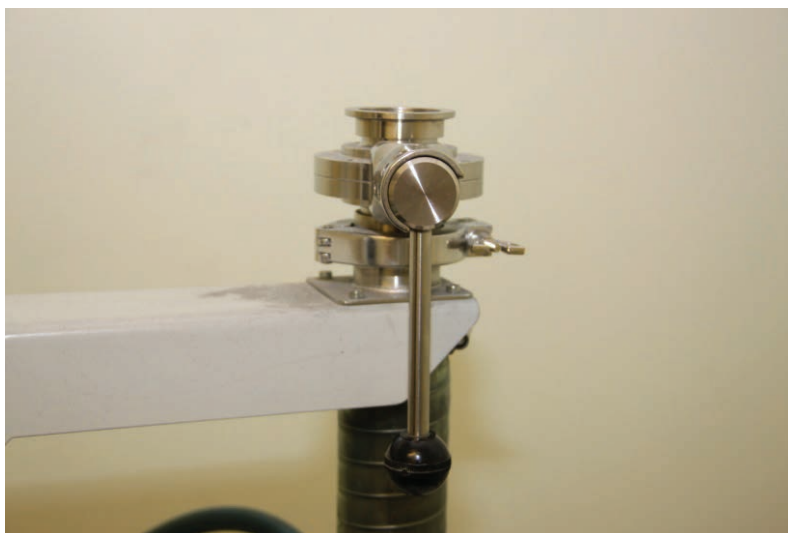
Figura 15 Válvula de isolamento superior do PRS
